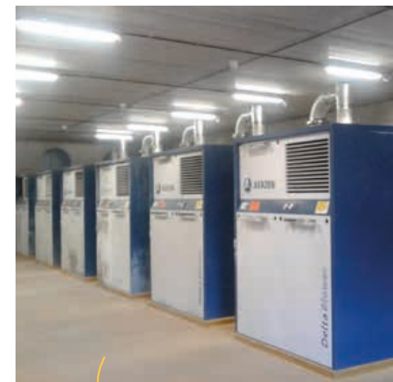
CENTRALISATIE BLOWERS WATERZUIVERING
